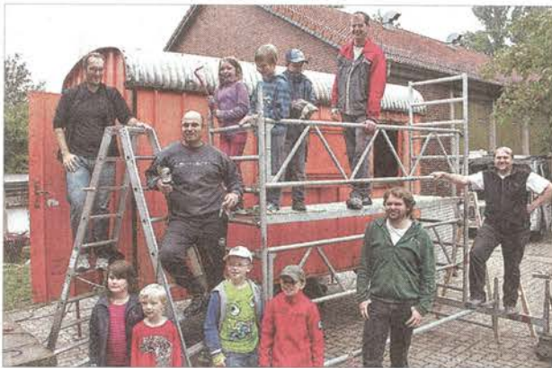
Die Firma Möhlenhoff saniert den 30 Jahre alten Bauwagen auf dem Schulhof der Heinrich-Albertz-Schule.
