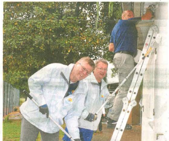
Die WEVG-Mitarbeiter Welkhard Glahe, Torsten Zink und Björn Lippold strichen die Fassade des Vereinsheims beim MTV Immendorf.
